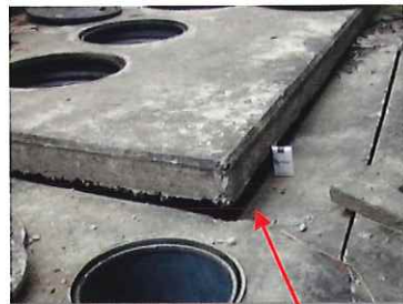
槽本体の浮き上がり
