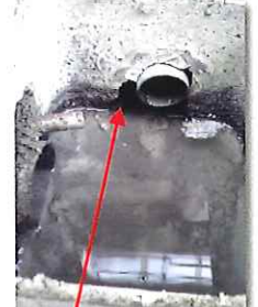
放流側の弁の劣化(処理水の漏水)
