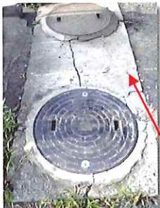
槽上部コンクリート(スラブ)の破損
