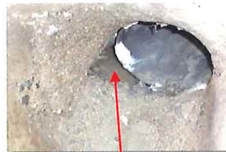
流入側の点検弁の破損(汚水の漏水)
