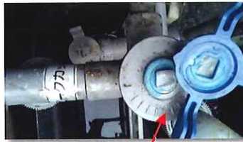
空気調整バルブの破損
